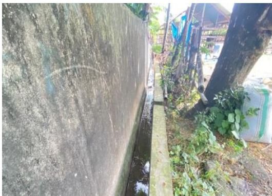
Gambar 3. Kondisi selokan di luar ruangan pemotongan hewan
