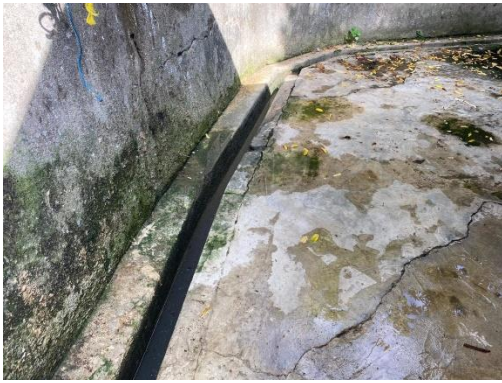
Gambar 2. Kondisi selokan dalam ruangan pemotongan hewan
